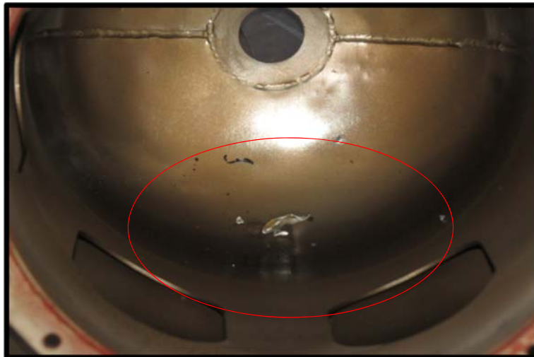
Fotografía No. 26 Residuos de metal encontrados en la sección de cámara de combustión.
